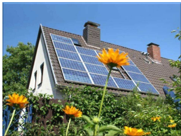
Εικόνα 12: Οικιακά Φωτοβολταϊκά Συστήματα ( green-mech.gr )
